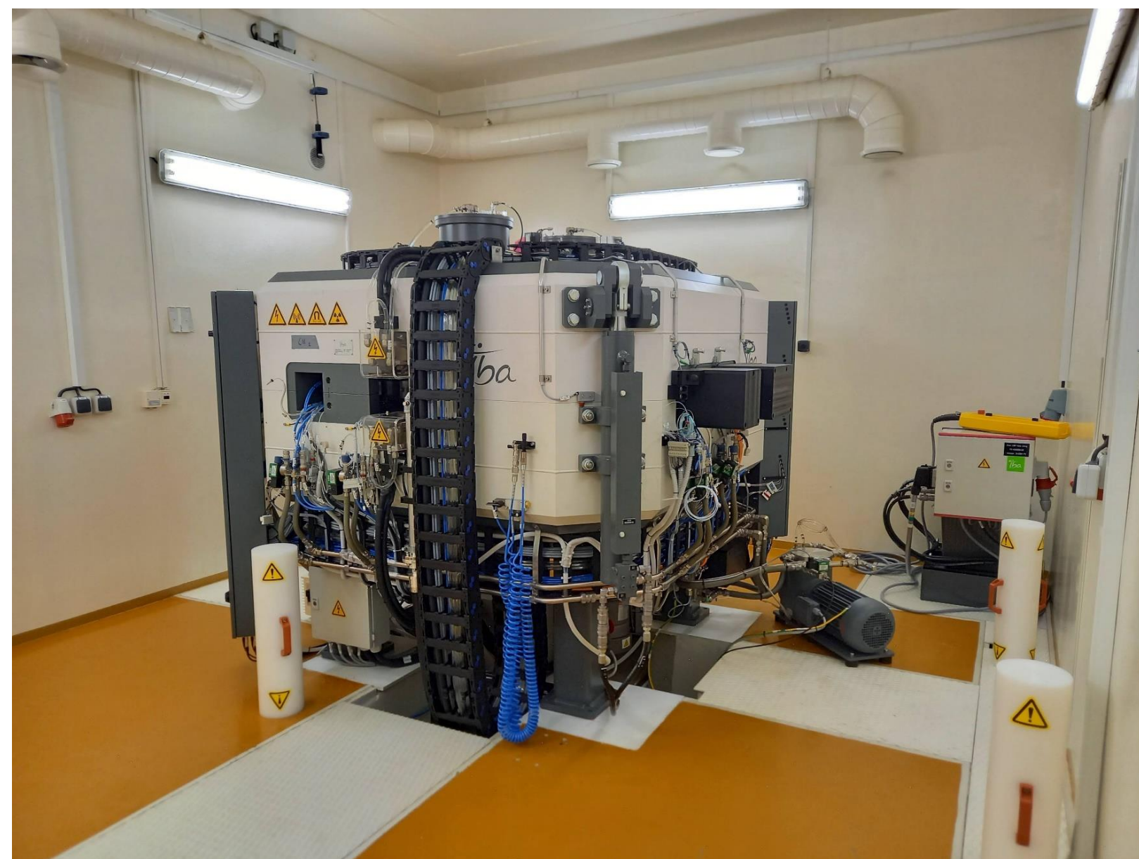
PET Praha – Cyclone KIUBE 150, rok instalace 2022/2023
